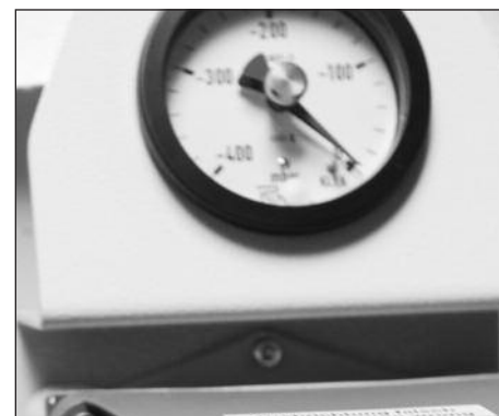
9. Der angezeigte Manometerwert muss nach Wechsel des Vlieses wieder deutlich VOR dem eingestellten Zeigerwert liegen.
