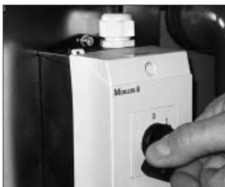
Pumpe betriebsbereit schalten
